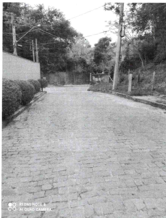
Foto 04/06 (Vista da junção das Ruas Cristiano Ribeiro Filho e Rua Izabel Herdy Alves)
